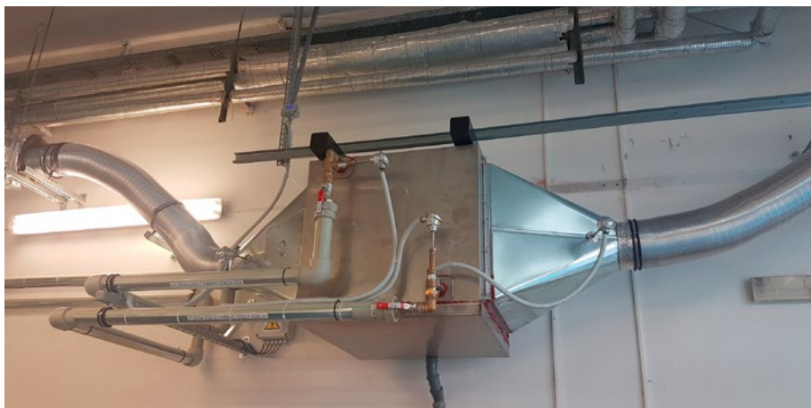
Výměňník vzduch-voda včetně měřicích a regulačních prvků.
